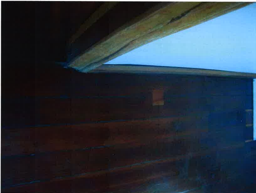
Fotografía N° 6: Integración piso no sigue los parámetros establecidos según las especificaciones técnicas
